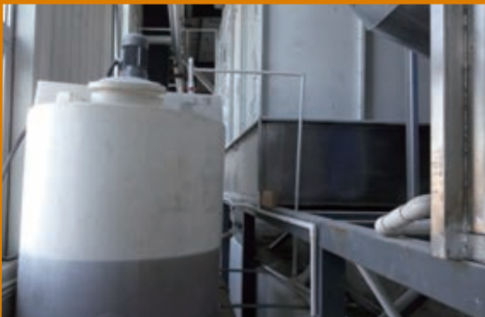
板式傢具廠廢水處理裝置
