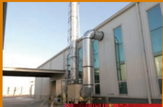
海綿發泡廢氣處理裝置2
