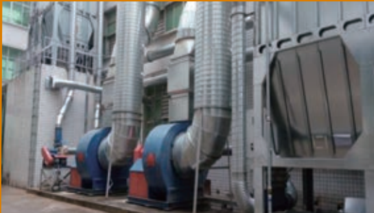
木工車間粉塵處理裝置
