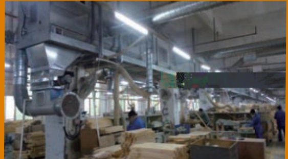
木工車間粉塵收集裝置
