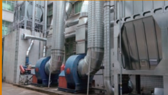
木工車間粉塵處理裝置
