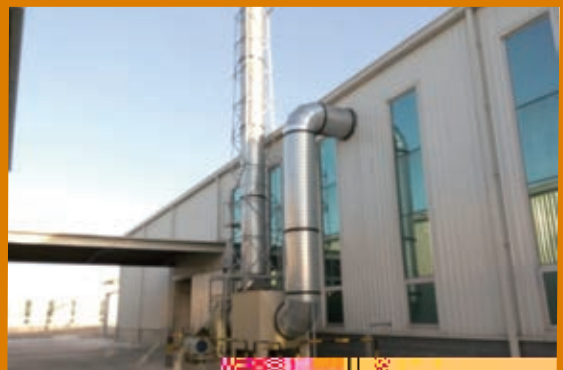
海綿發泡廢氣處理裝置2
