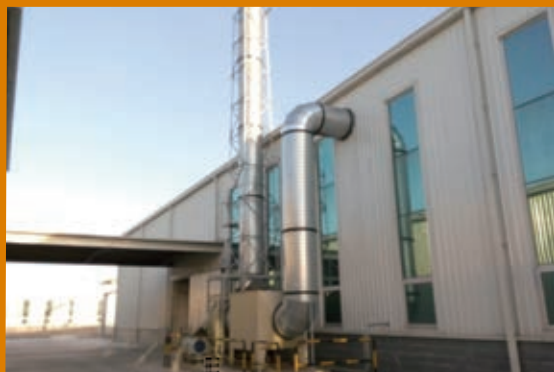
海綿發泡廢氣處理裝置2
