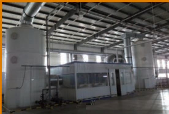
海綿發泡廢氣處理裝置1
